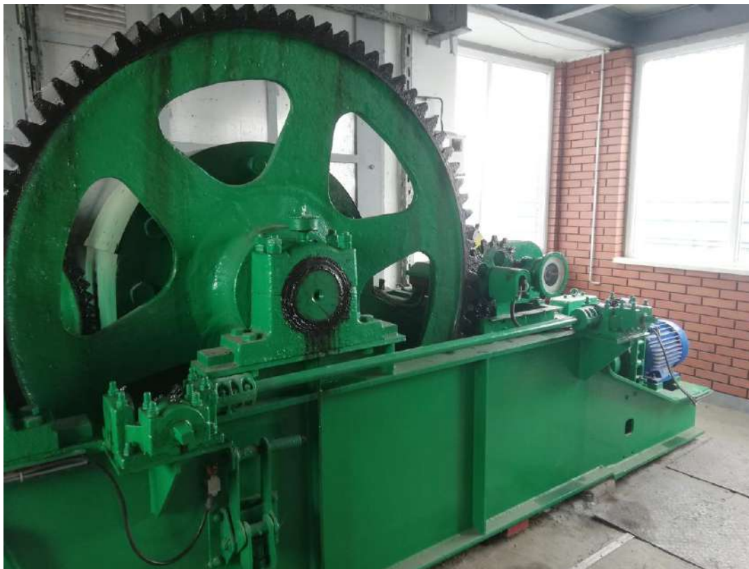
Mechanizm podnoszenia i opuszczania zamknięć jazu.
